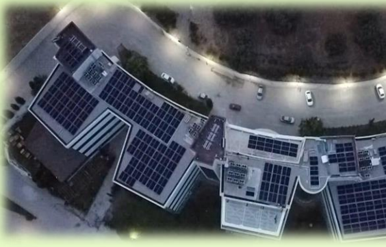
Çatıya Monte Edilen Güneş Paneli Örneği (MCBÜ Teknokent, Manisa)
