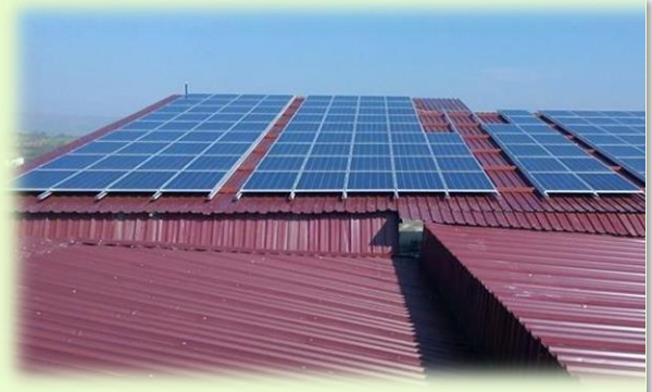
Çatıya Monte Edilen Güneş Paneli Örneği (MCBÜ Köprübaşı MYO, Manisa)
