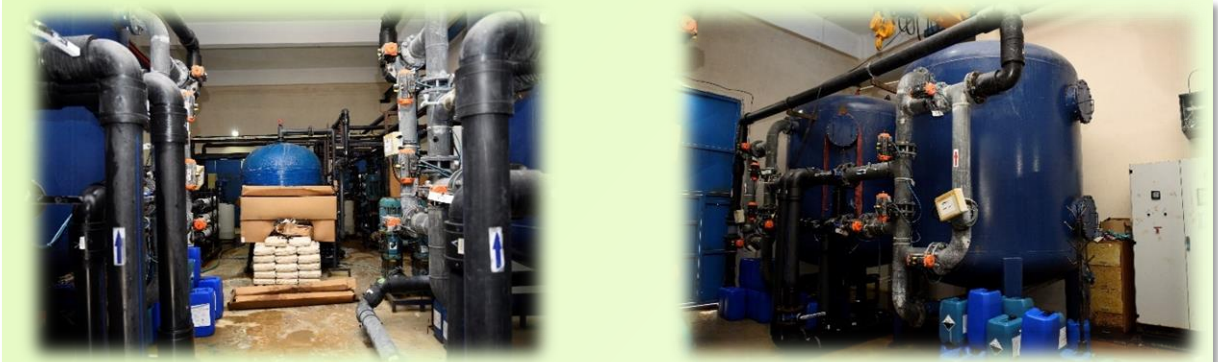
Şekil 5.3 Manisa Celal Bayar Üniversitesi içme suyu arıtma tesisi
