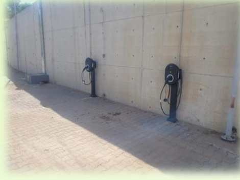
Şekil 6.6. Elektrikli araç şarj istasyonları
